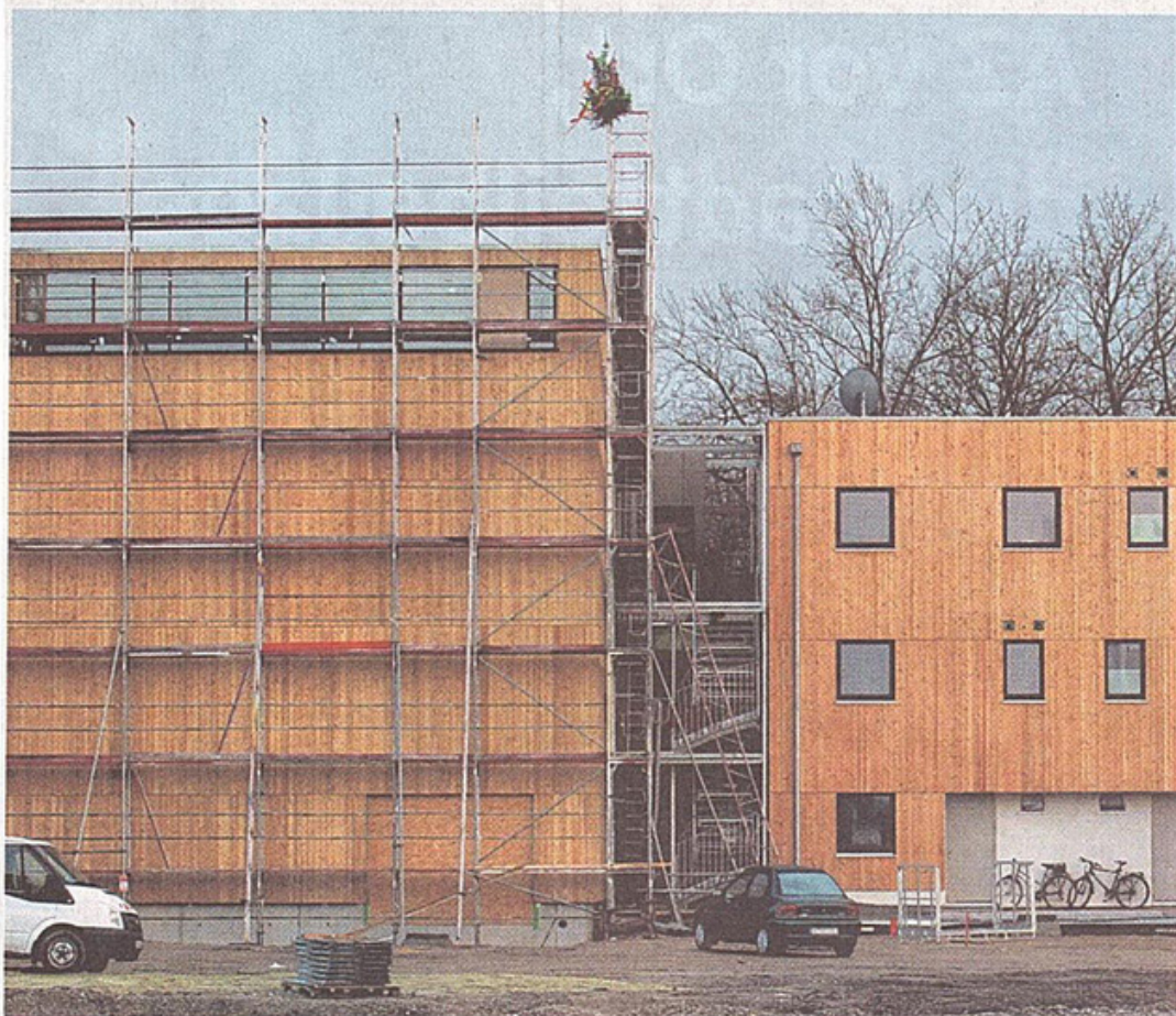
Von außen erinnert wenig an eine Kirche: Die alt-katholische Gemeinde feierte auf dem Sheridan-Gelände das Richtfest ihres Gotteshauses. Das Nebengebäude mit Pfarrbüro und Wohnungen ist bereits bezogen.
